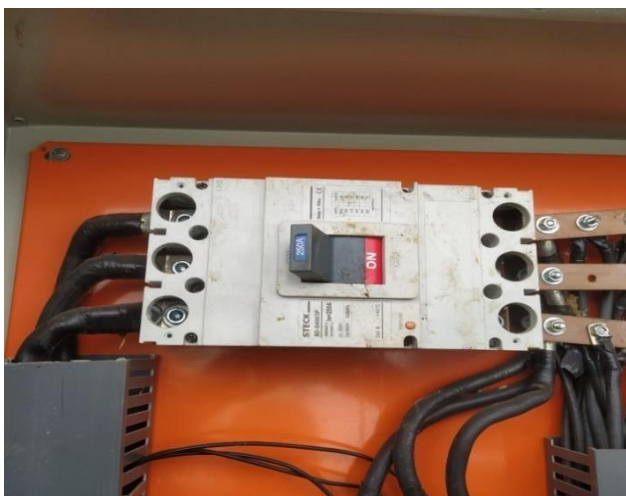
Disjuntor Geral – Quadro secundário 250A
