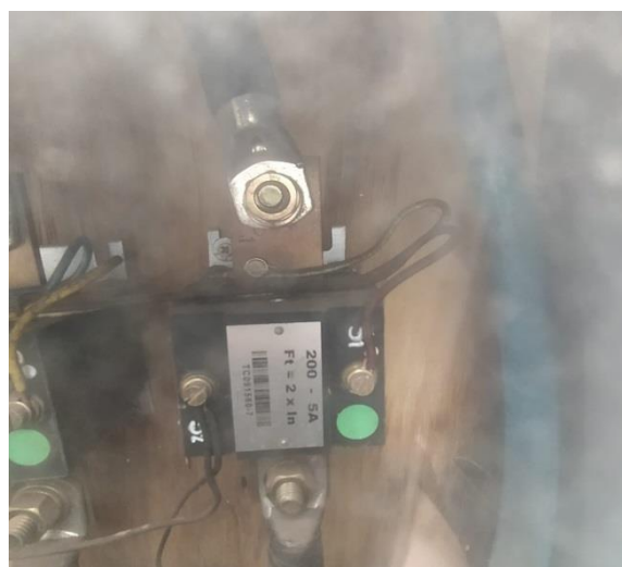
Transformador de Corrente
