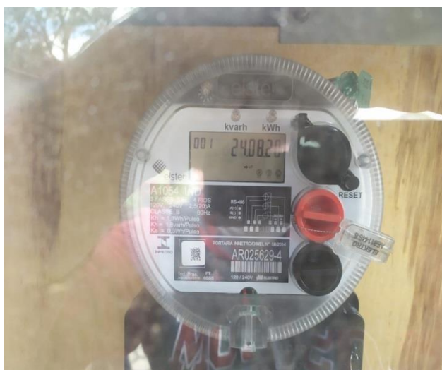
Medidor de Energia
