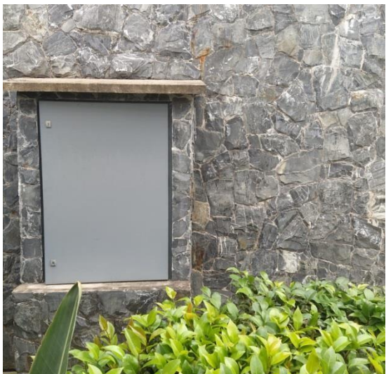
Quadro de energia Secundário
