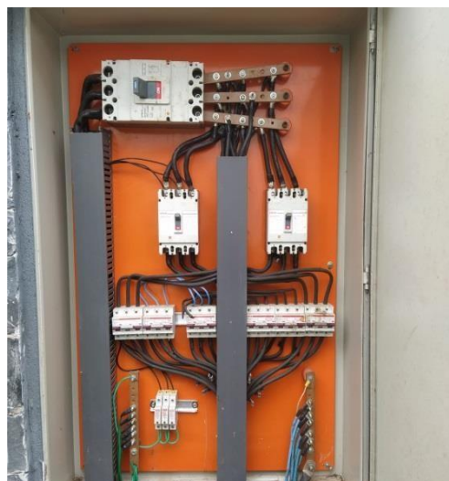
Visal geral – Quadro Secundário
